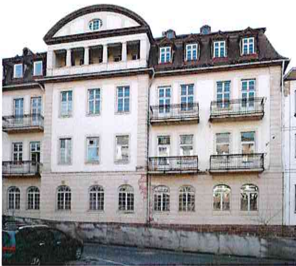
Historische Bausubstanz in schlechtem baulichem Zustand
